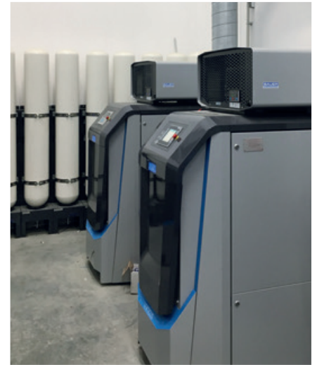
VERTICUS Anlagen im Einsatz beim Kühlerspezialist Güntner
