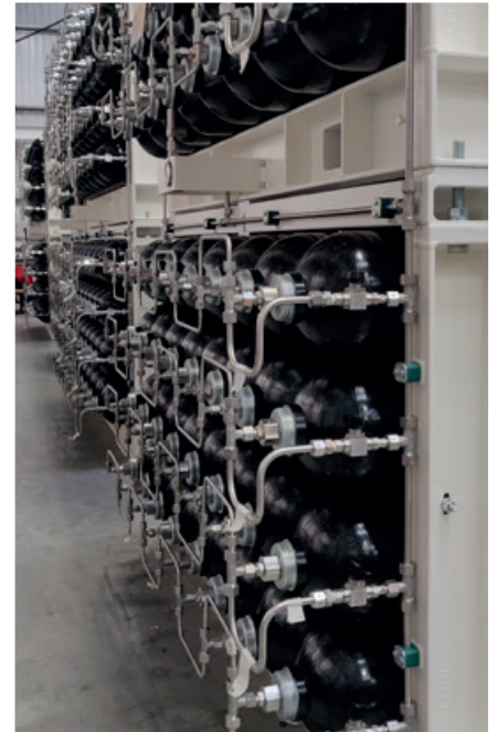
Speicheranlage im Test
